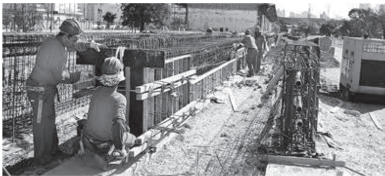
Cerca de 30 pessoas estão trabalhando na obra. Ponte terá um vão de 22 metros
